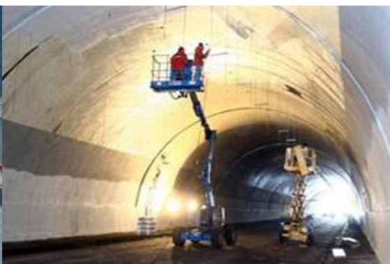
Umberto I Tunnel – Rome, Italy redukce NOx o 20%
