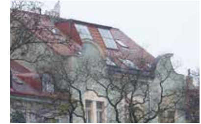
nevhodné – zde měla být jen stř. okna v PZ
