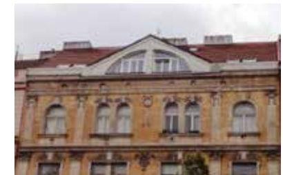
nevhodné doplnění štít. vikýře – chybný tvar otvorů v PZ
