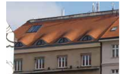
nevhodné umístění volských ok na mezi- válečném objektu, zde měla být jen ateliérová okna v kombinaci se střešními
