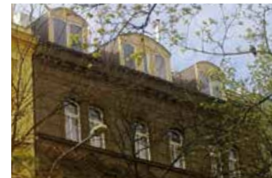
tvarově i rozměrově nevhodné řešení vikýřů v PZ
