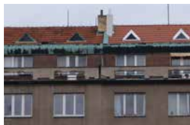
doplnění trojbokých vikýřů vpravo, historické jsou vlevo – vikýře měly být s měděným oplechováním – PZ
