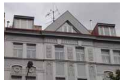
nevhodné doplnění štít. i pult. vikýřů – měla být jen stř. okna
